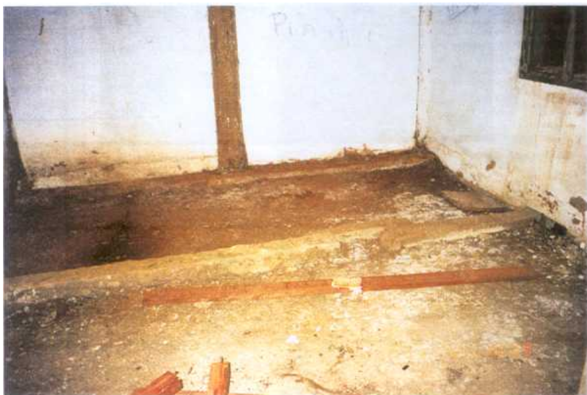
Fig 19 Escotono evidência de assobalho no piso
